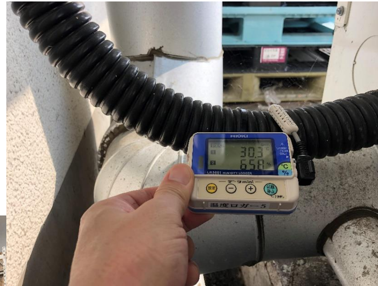
外気温度ロガー設置
